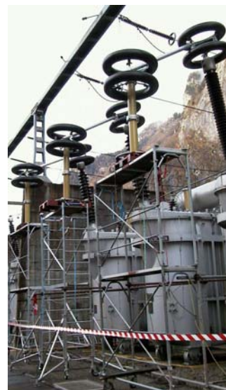
Bild 9 TE-Messung mit externen Koppelkondensatoren (Durchführungen ohne Messanschluss). Die Verbindung zwischen Koppelkondensator und Durchführungsanschluss ist TE-frei mit Rohrverbindungen ausgeführt
