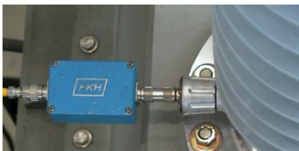
Bild 7 Koaxialer Anschluss eines HF-Wandlers (TE-Sensor) an den Messbelag der Durchführung
