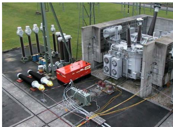
Bild 1 Prüfspannungserzeugung an einem 600 MVA Netzkupplungstransformator mittels Diesel-Generator (nur ein Hauptpol mit Regulierpol abgebildet, Bildmitte: Step-Up-Transformator und Generator)
