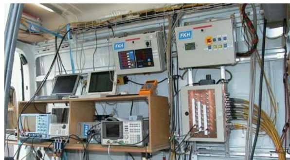
Bild 5 Messeinrichtung zur TE-Erfassung (eingebaut in Messfahrzeug): v. l. n. r.: zwei Oszilloskope (DSO), Impulsverarbeitungssystem (ICM), Spektrum-Analysator, „Switch-board“; oben: Steuerung der Spannungsquelle
